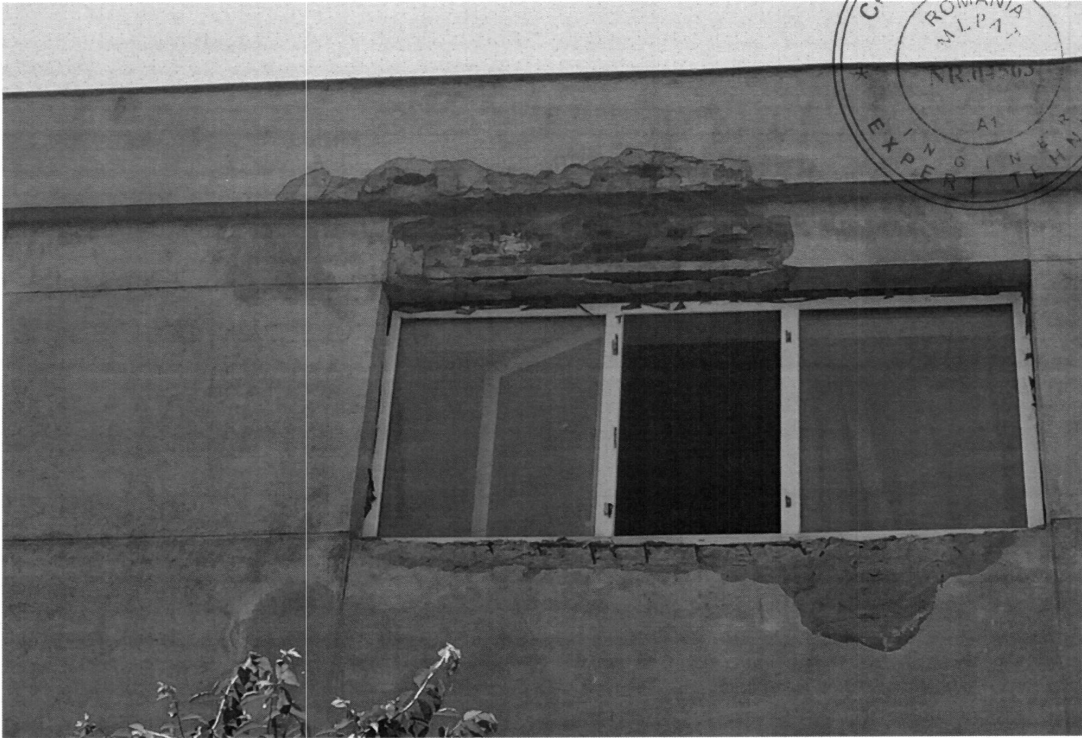
Foto nr. 5 Tencuieli deteriorate fațadă
