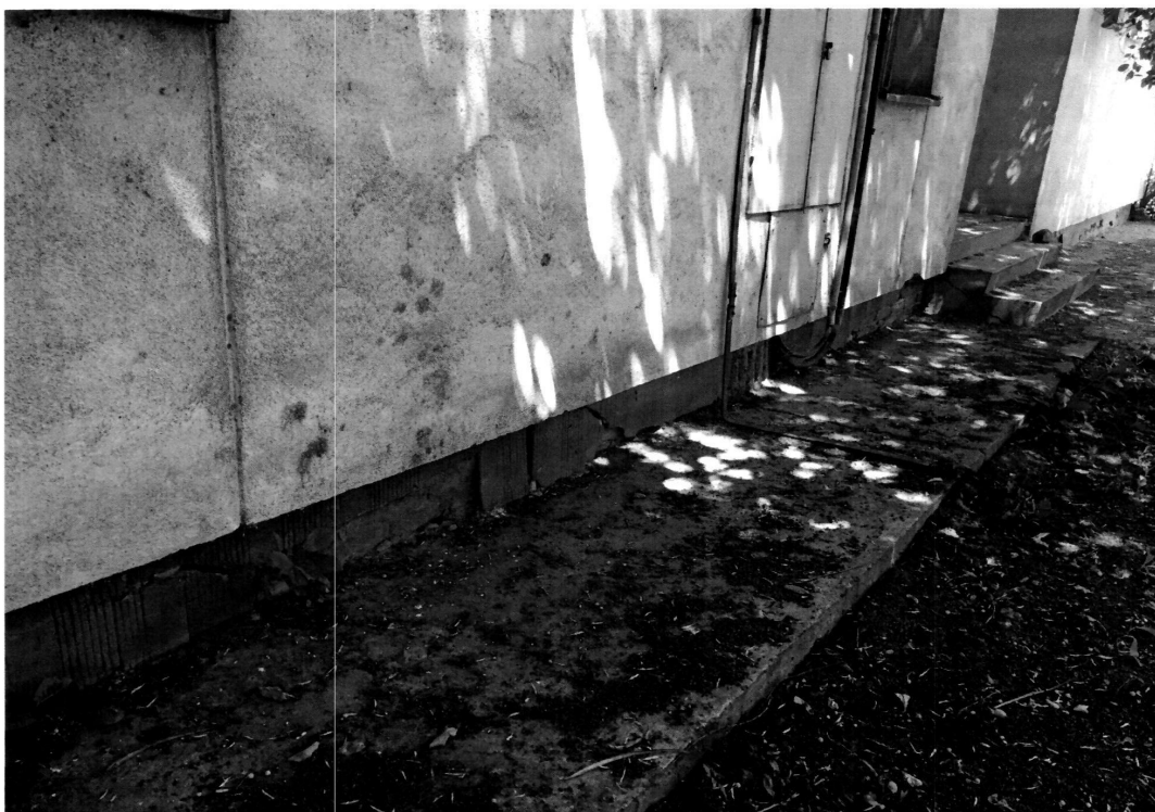
Foto nr. 4 Tencuiele Desprinse Soclu
